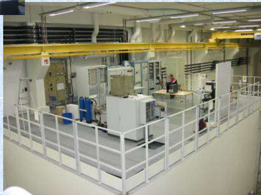
Стойки систем питания и управления МСС-30/15 в Университете г. Ювяскюля
